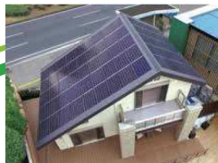
太陽光発電システム
